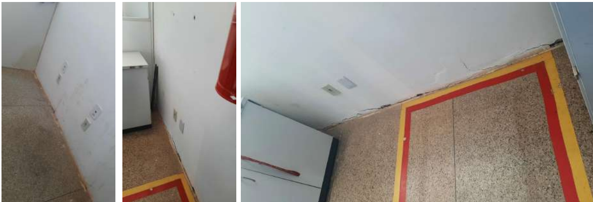
Imagem 23, 24, 25 e 26 – Fissuras e infiltrações em paredes. (JUN/2021)
