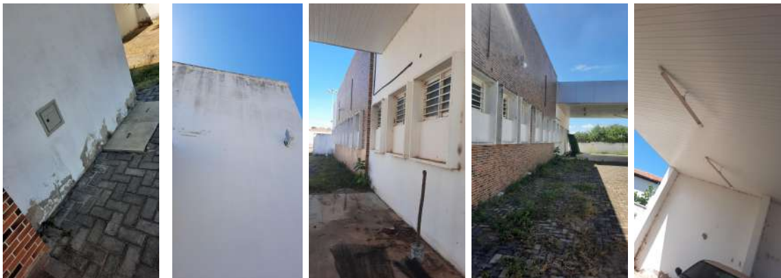
Imagem 5,6,7,8 e 9 – Área externa - Necessidade de pintura, remoção de vegetação e revisão de pontos elétricos. (JUN/2021)
