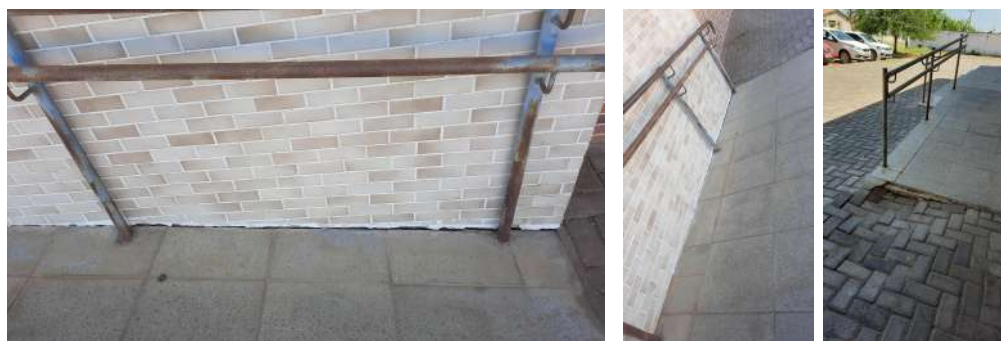
Imagem 10 e 11 – Área Externa - Revisão do piso intertravado onde há afundamento/ Manutenção corretiva em rampa. (NOV/2020)
